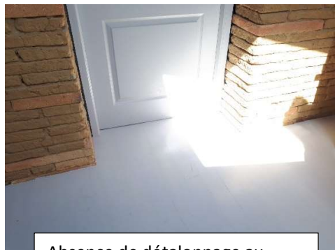
Absence de détalonnage au niveau des portes de la maison
